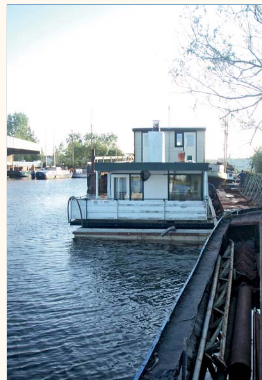
Stalen woonschip is met behulp van een drijvend dok in een betoncasco geplaatst.
